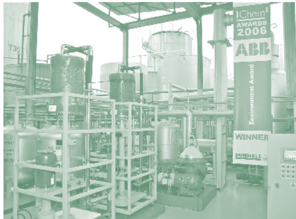
正昌的廢油回煉廠房設備。
